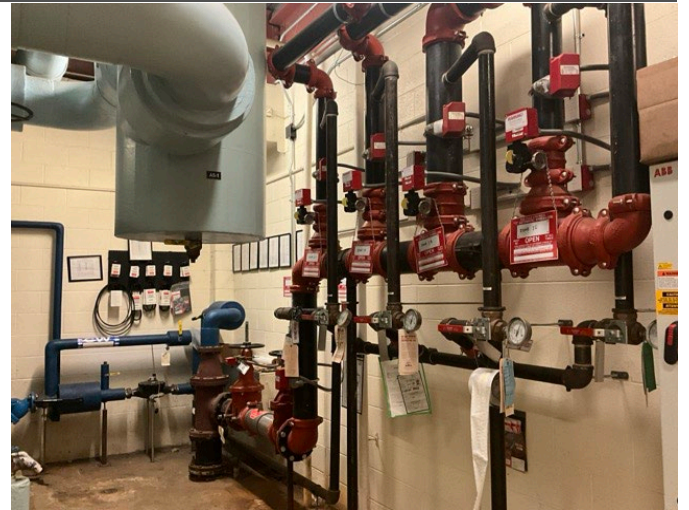
26 - FIRE SPRINKLER RISERS
